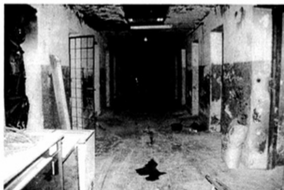
Estado de uno de los Pabellones al recibir el edificio
